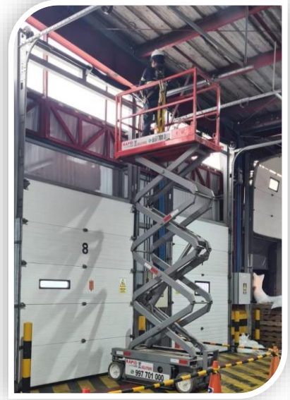
Mantenimiento de: Puerta seccional
