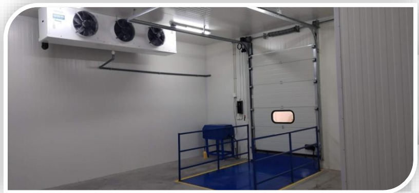
Instalación de cámaras con paneles
